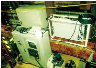
タッチパネル操作盤坑内設置状況
