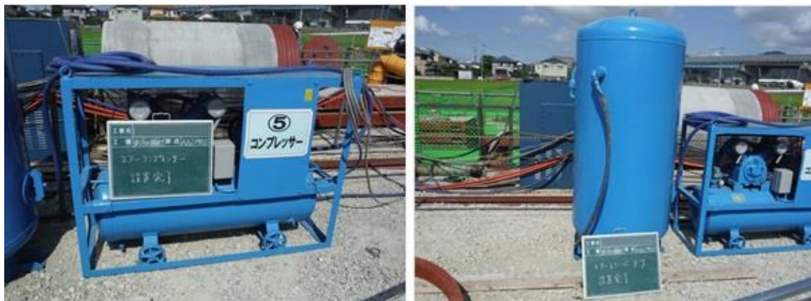
エアコンプレッサおよび大型エアタンク設置状況写真(参考)
