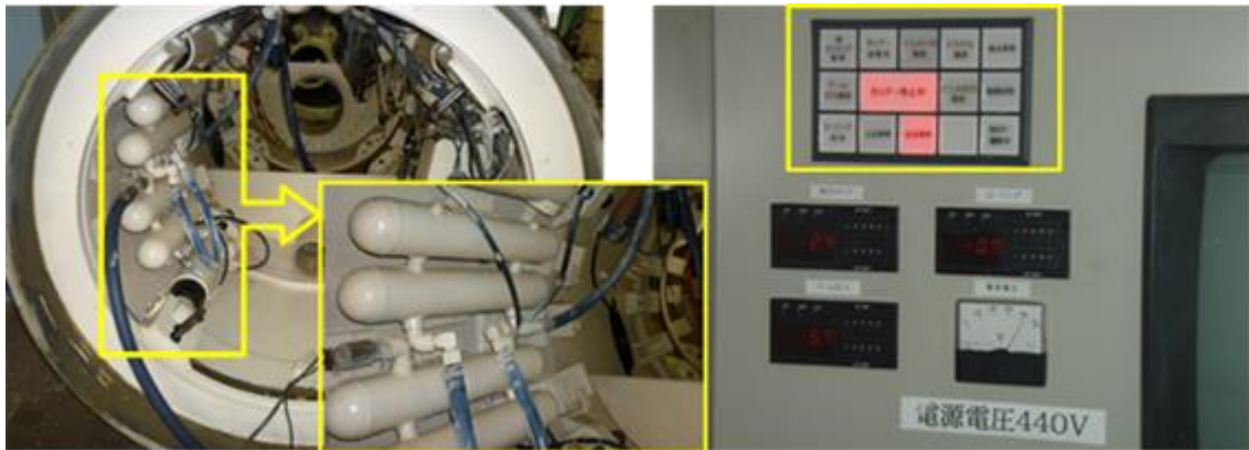
掘進機内の予備タンク設置状況および遠隔操作盤における警告ランプ点灯状況写真(参考)
