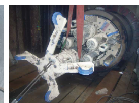
リターン回収状況(駆動一体)
